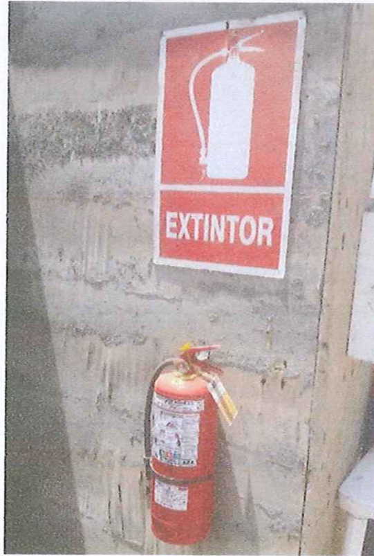
EXTINTOR EN OBRA
